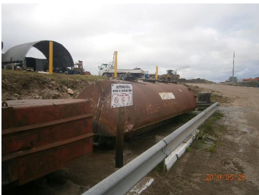
Ilustración 9 - Tanques de acopio de combustible con muro de contención y piso compactado impermeable
