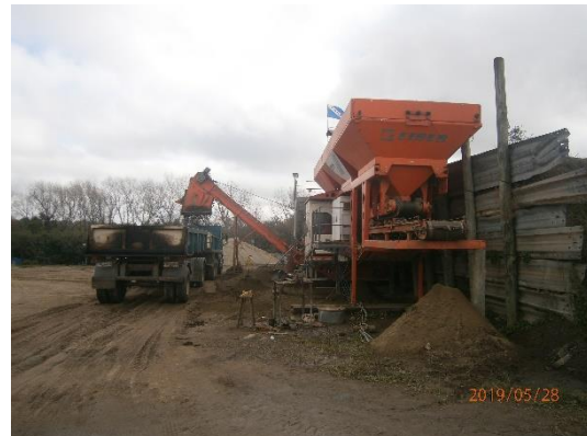
Ilustración 20 – Planta de asfalto
