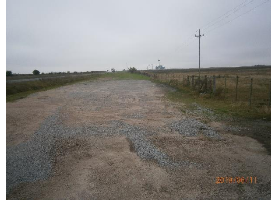
Ilustración 5 – Sector de acopio de material granular y piletas de mezcla asfáltica desmantelado con suelo compactado en faja pública
