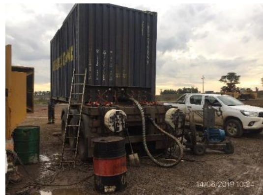
Ilustración 9 – Campamento provisorio en Ruta 26, depósito de emulsión asfáltica
