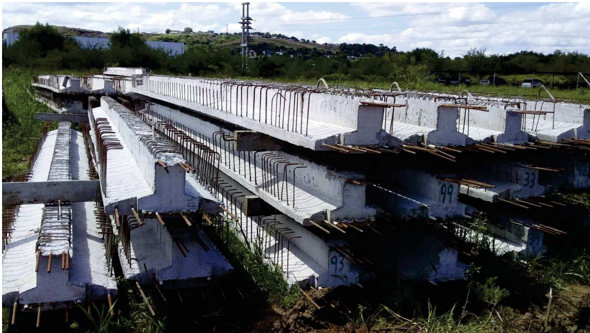
Imagen 5 – Acopio de losetas prefabricadas pretensadas
