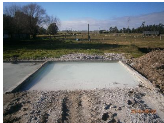
Ilustración 9 – Piletas de lavado con restos de material.
