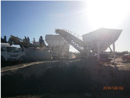
Ilustración 10 – Planta de producción de hormigón
