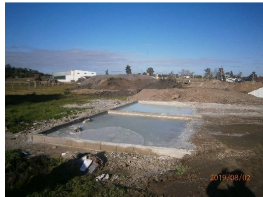
Ilustración 7 – Piletas de lavado con restos de material
