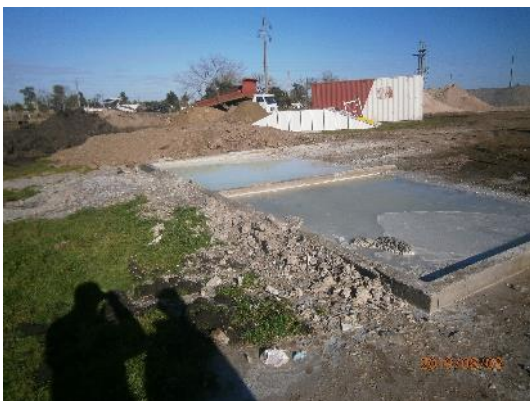
Ilustración 8 – Piletas de lavado con restos de material
