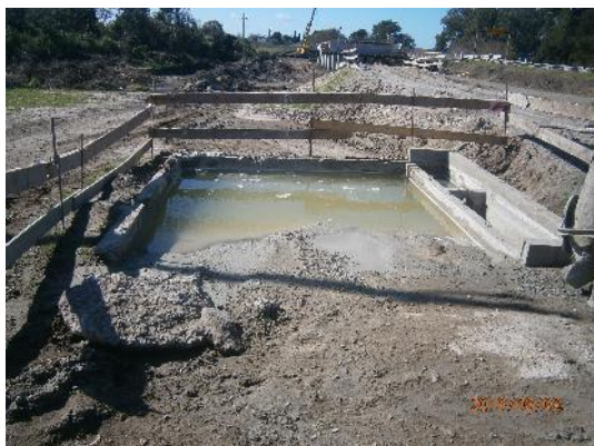
Ilustración 12 – Lavadero de camiones y máquinas de hormigón.
