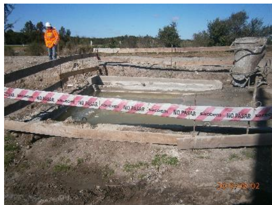
Ilustración 13 – Lavadero de camiones y máquinas de hormigón.
