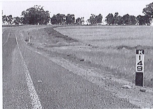
Si bien existen en el lugar señales que indican "gravilla suelta", no son la cantidad suficiente como para ayudar al usuario a permanecer atento.
