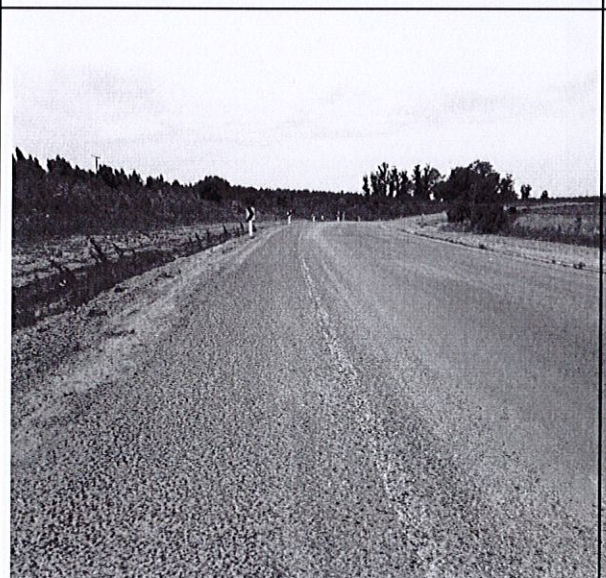
123k000: Material suelto sobre calzada y banquina. Representa especial peligro para la adherencia neumático-calzada. Son lugares sin iluminación, por lo que se agrava la situación.
