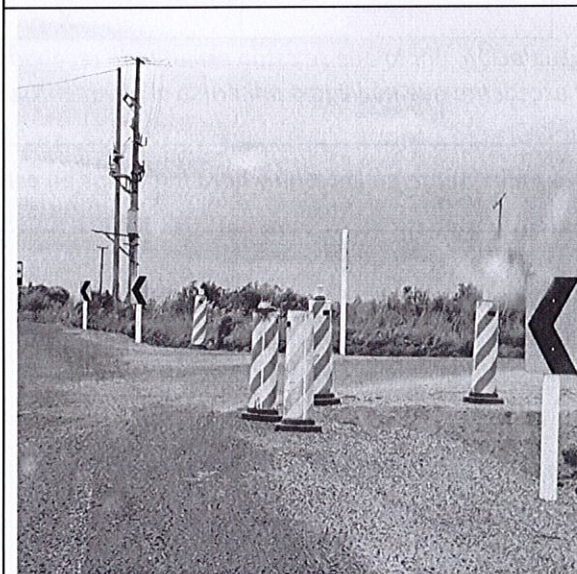
B: Balizas en mal estado, sin luz y con pérdida de reflectivo. Desnivel importante en intersección de ruta 7 y 56. Sustituir balizas e instalar los elementos de contención correspondiente a la situación.
