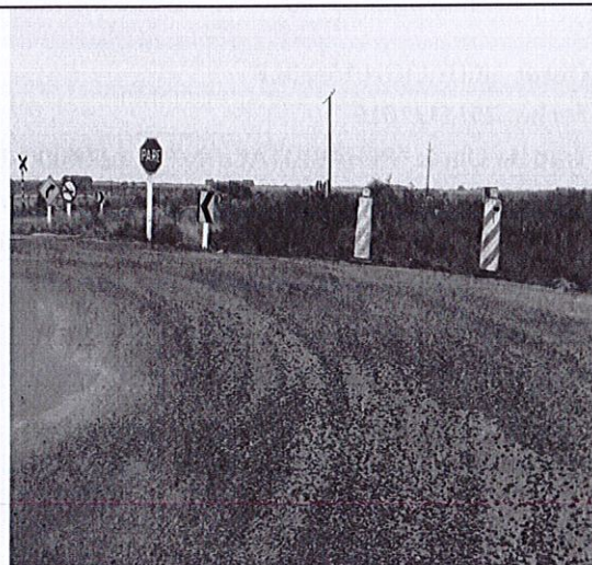
Curva con material granular sobre calzada, previo al cruce de ruta y de la señal de "PARE". Balizas deterioradas.
