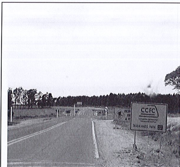
A1: Señales de obra, acorde a la situación, de diseño adecuado, material reflectivo, pero muy juntas, se superponen, lo que impide su correcta apreciación.
